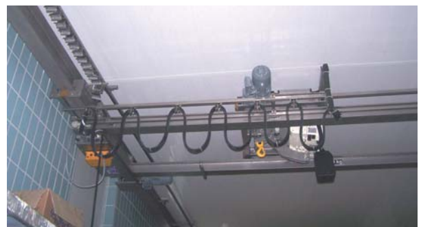
Stromzuführung mit Flachkabel
